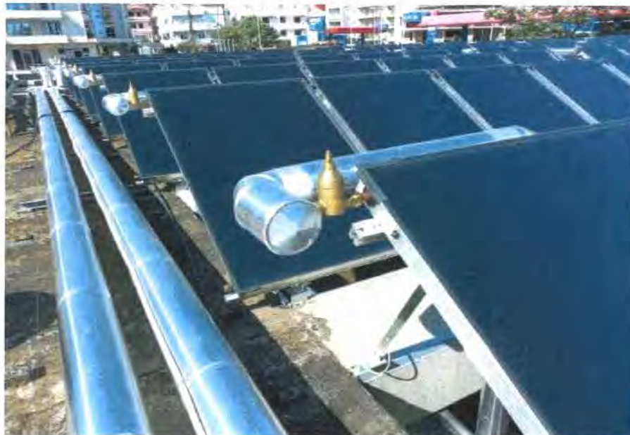
Solarni paneli u TN Slovenska plaža
