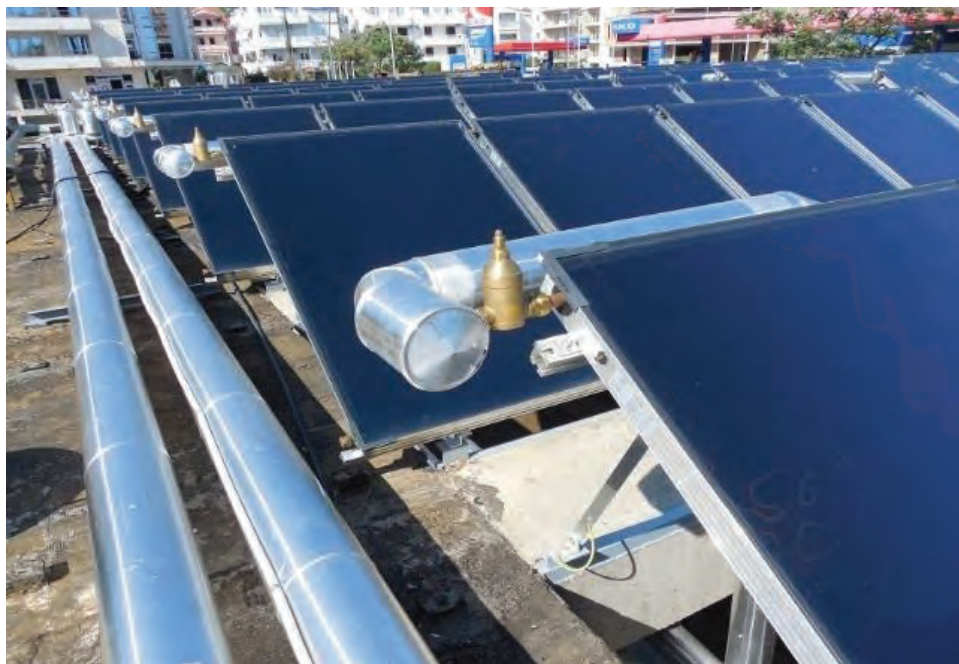
Solarni paneli u TN Slovenska plaža
